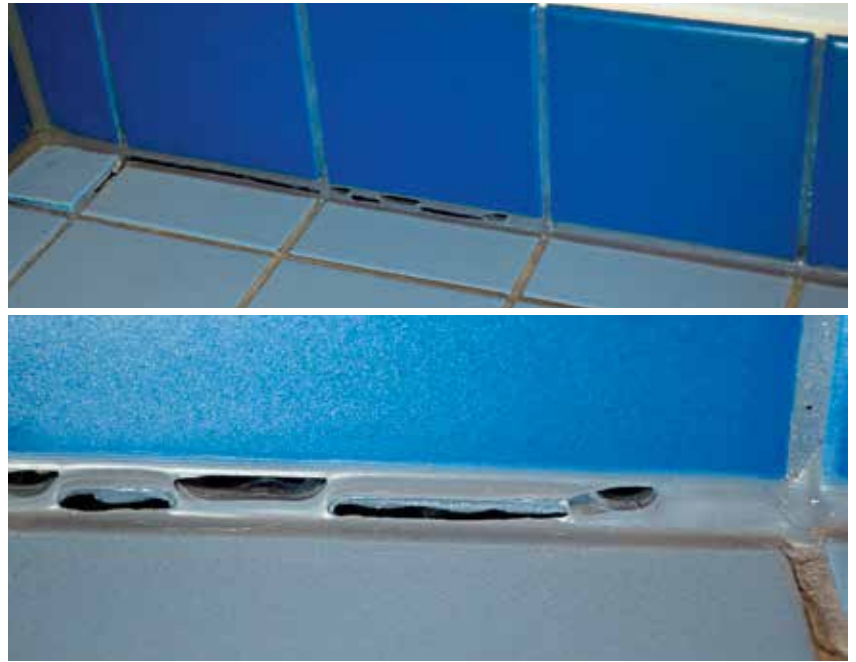
In den Leistungsverzeichnissen für „Fliesenarbeiten“ wird das Leistungssoll des Einarbeitens des Fugendichtbandes unmissverständlich beschrieben. Damit dürfte ein solcher Fehler eigentlich nicht mehr passieren.
