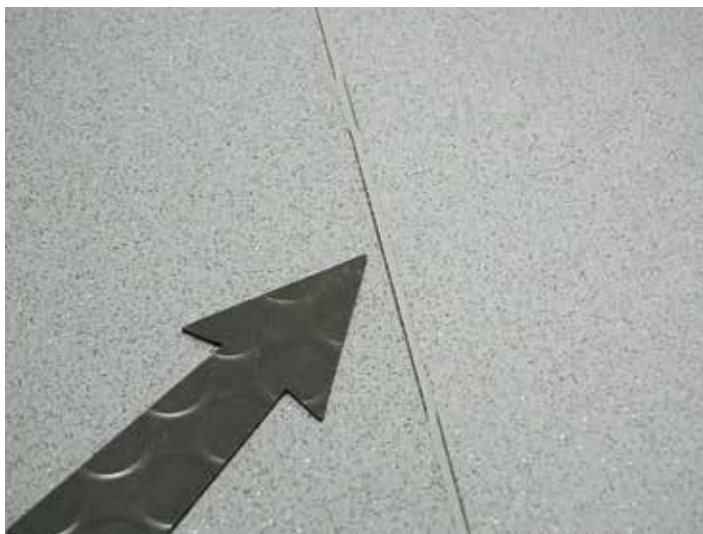
Bei Fugen geht es immer um die gleiche Frage: Darf der Auftraggeber auf einen Gewährleistungsanspruch pochen und innerhalb der vereinbarten Fristen eine Instandsetzung verlangen?
